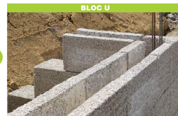
Utilisation des blocs U pour la réalisation de la poutre de ceinture en béton armé dans l'évidement*.
