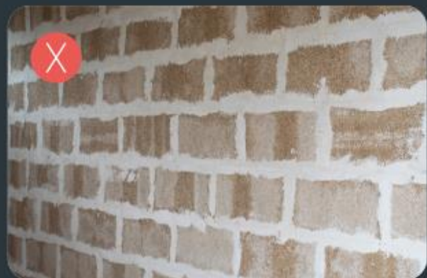
Mauvais traitement des joints
